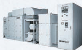
Einer der zentralen Solarwechselrichter (400 kW), die für das 1000-kW-System in Sajo City geliefert wurden.
